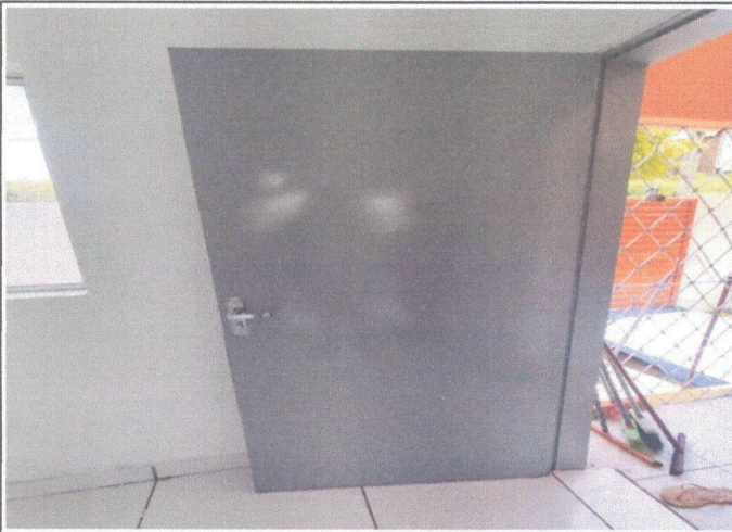
FOTO 13 - ESQUADRIA DE MADEIRA
